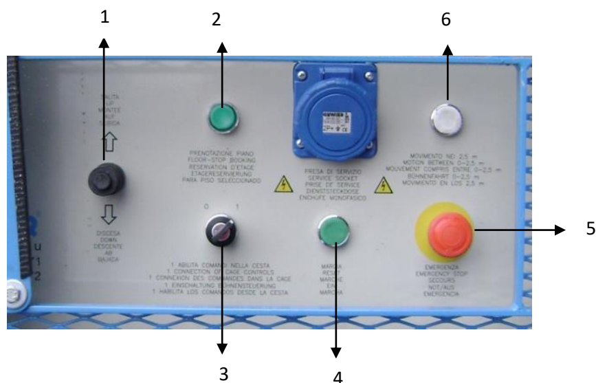
Fig. 1 : Bedieningspaneel in de lift / Tableau électrique dans le monte-charge / Electrical panel on transport cage
